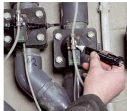
Wenn die zahlreichen Ventile in der Futterzentrale keine Kontrolldiode besitzen, sorgt der Testboy 130 für Klarheit.
